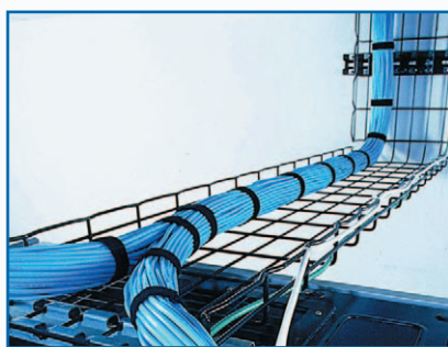
Кабельная трасса, проложенная в лотке Cablofil шириной 300 мм
